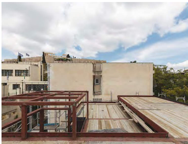
ΤΟ ΝΕΟ ΔΩΜΑ ΥΠΟ ΚΑΤΑΣΚΕΥΗ ΜΕ ΤΟ ΜΕΤΑΛΛΙΚΟ ΣΚΕΛΕΤΟ ΤΗΣ ΠΡΟΣΘΗΚΗΣ ΚΑΙ ΤΟ ΞΥΛΙΝΟ ΔΑΠΕΔΟ ΤΥΠΟΥ ΚΑΤΑΣΤΡΩΜΑΤΟΣ.
